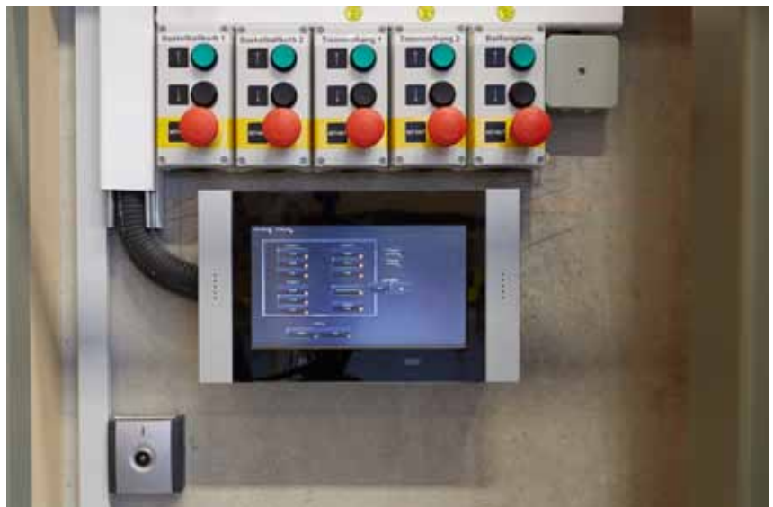
XS4 Wandleser mit SALTO Relaisboard zur Steuerung der Hallenabtrennungen u. a.
